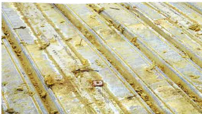
Rénovation de toiture avec élément porteur existant en bac acier d'un local classé en très forte hygrométrie : rouille blanche de l'acier et fixations mécaniques fortement corrodées.
